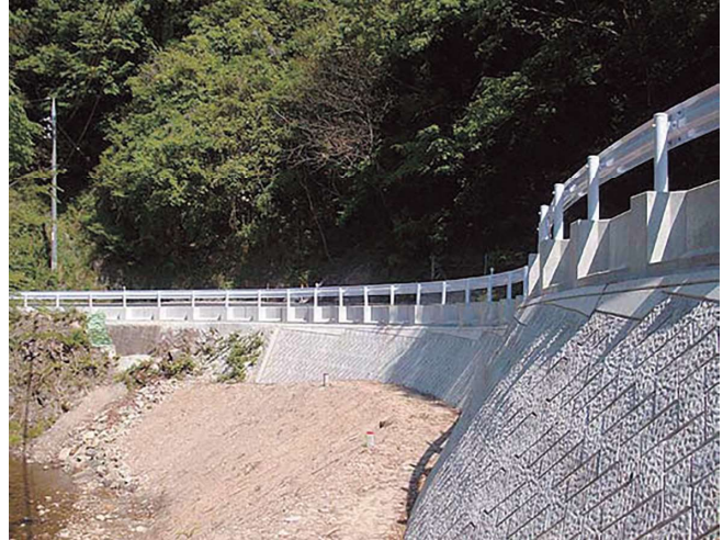
積ブロック直上設置の事例
