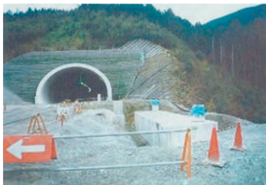
■トンネル洗浄用水槽
